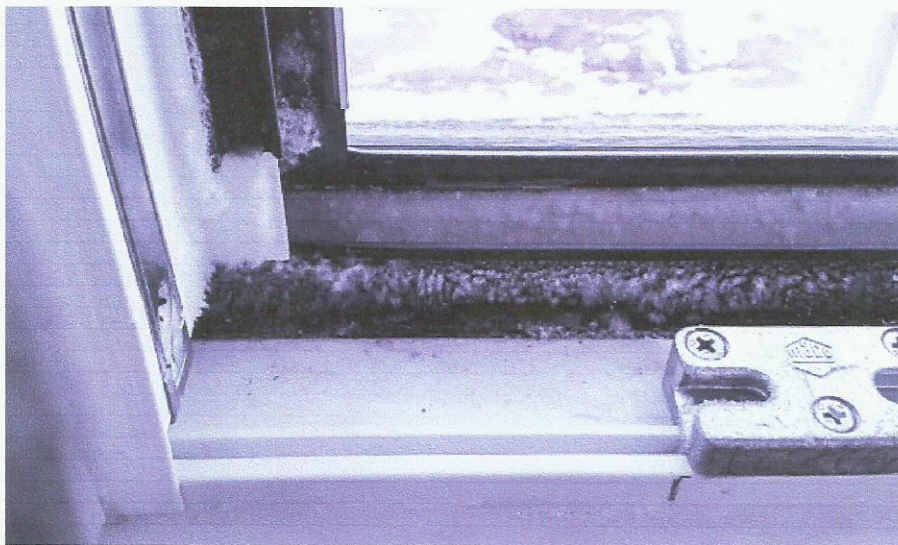
Kleinste Fugen an der Dreh-Kipp-Schere reichten aus, um diesen Schaden entstehen zu
